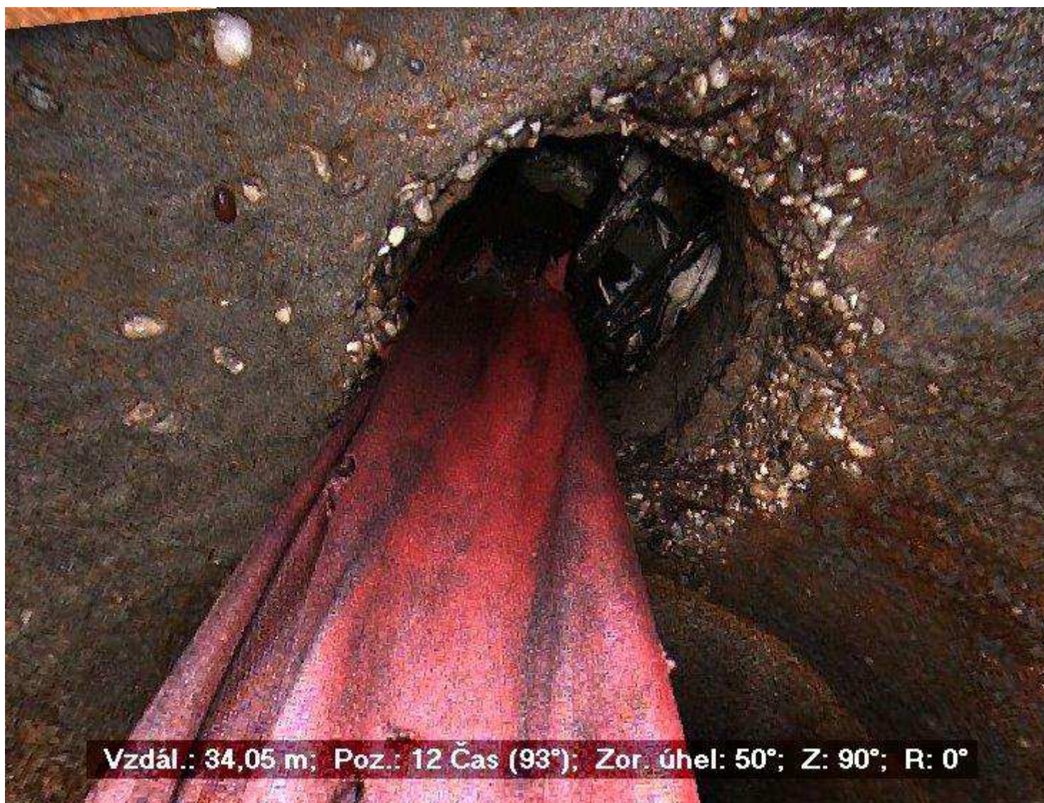
Textilný odpad v kanalizácií
