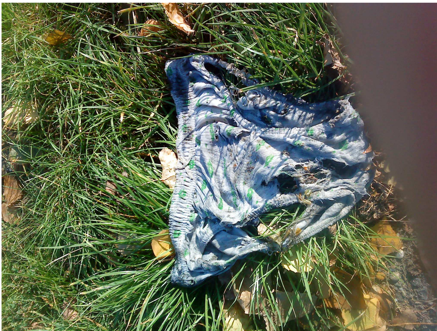
Spodné prádlo vytiahnuté z čerpadla
