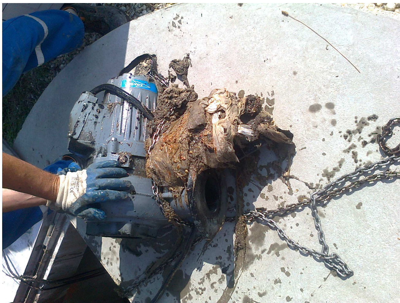
Textilný odpad v čerpadle
