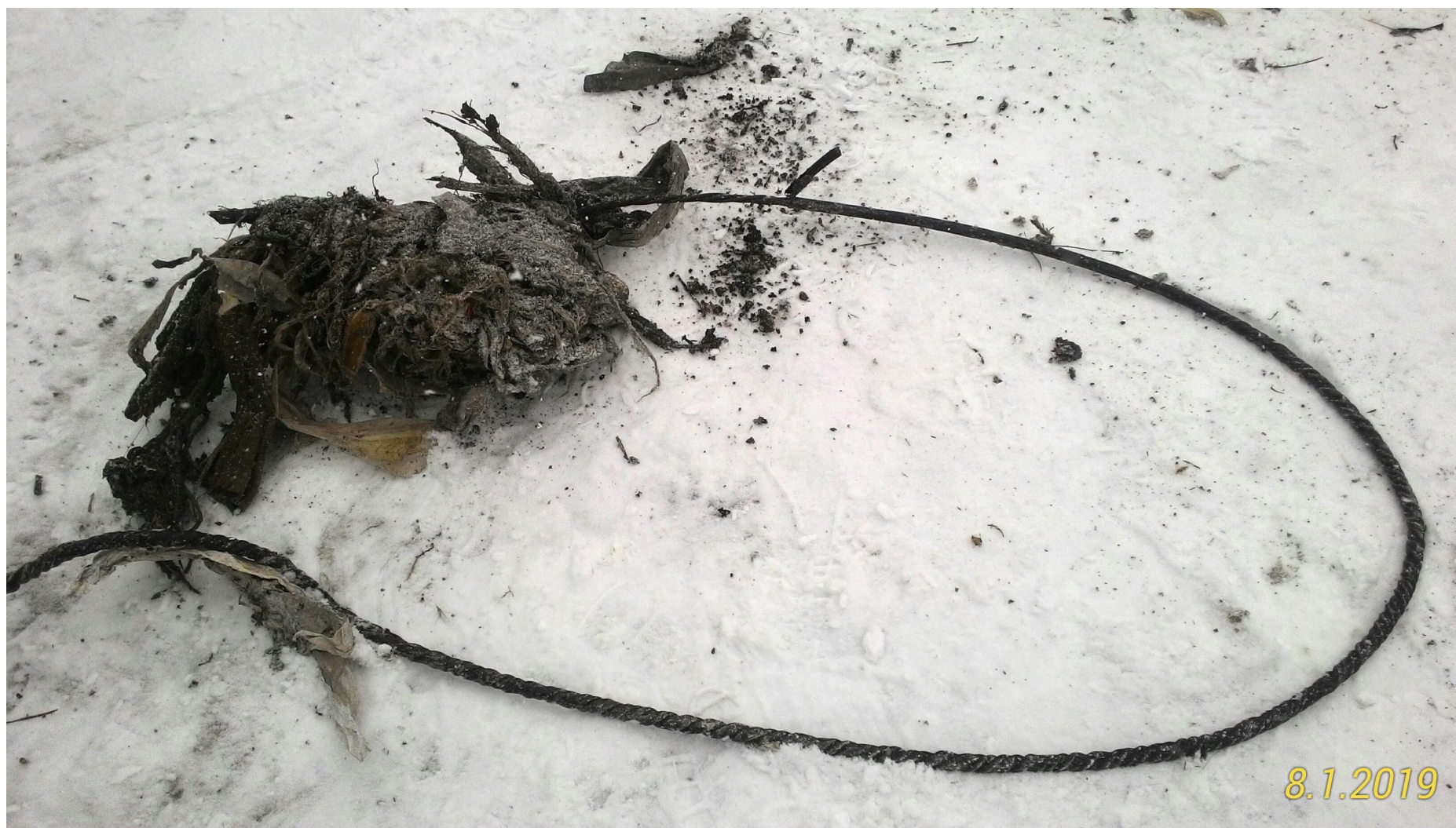
Lano so zachyteným odpadom vytiahnuté z kanalizácie
