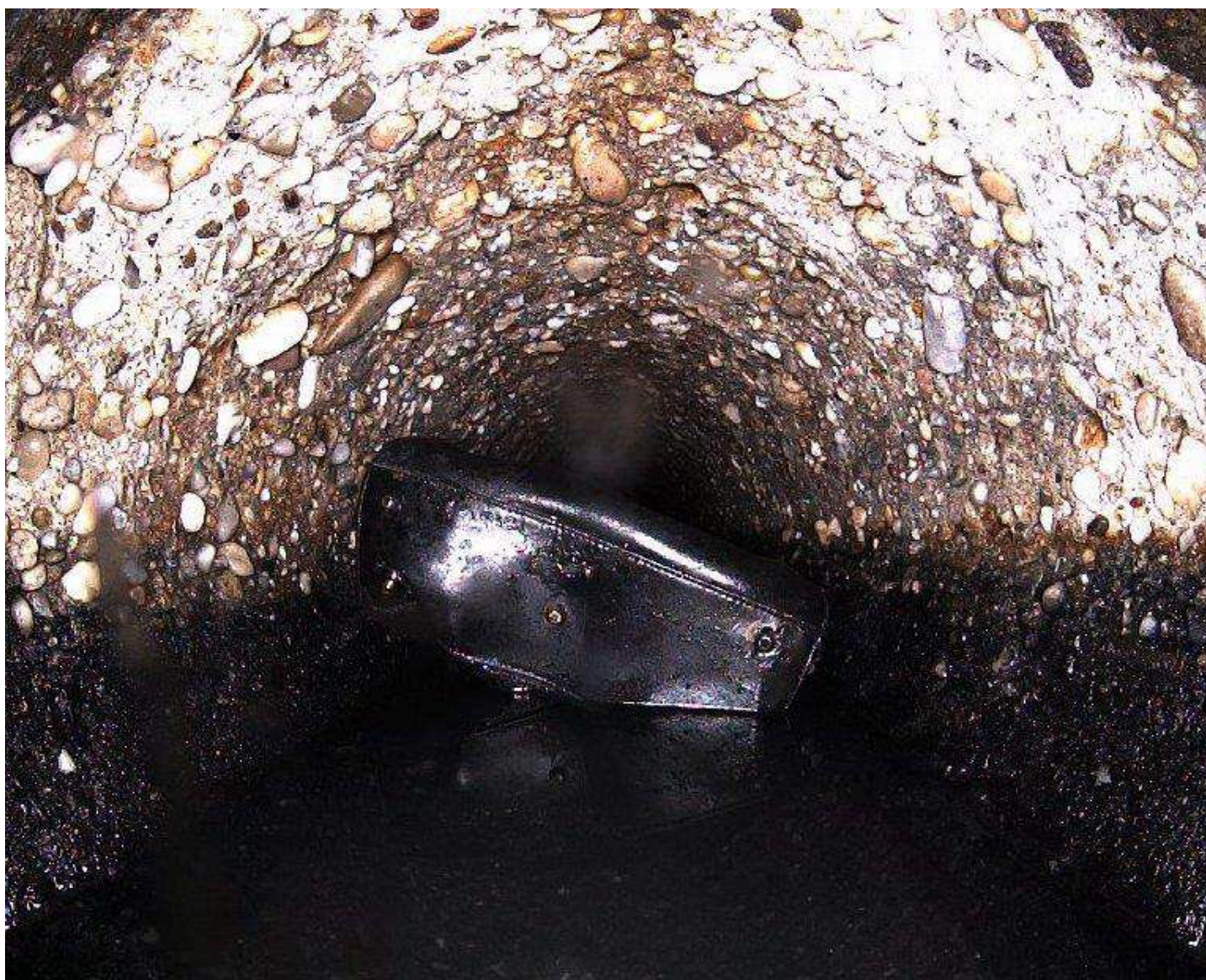
Kabelka v kanalizácii
