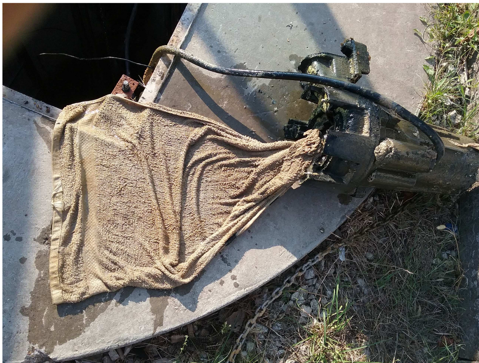
Uterák v čerpadle přečerpávací stanice
