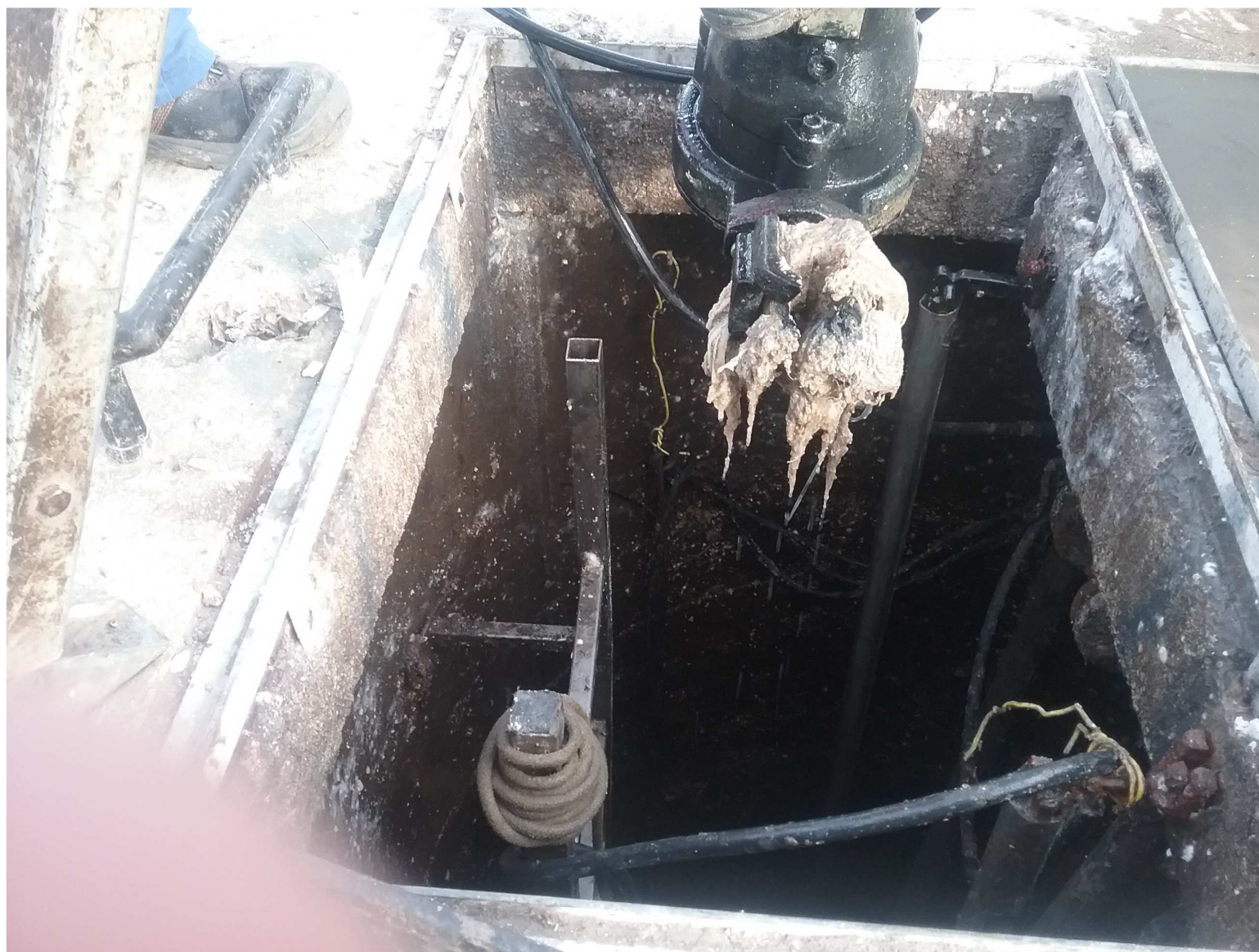
Plastové predmety namotané na čerpadle
